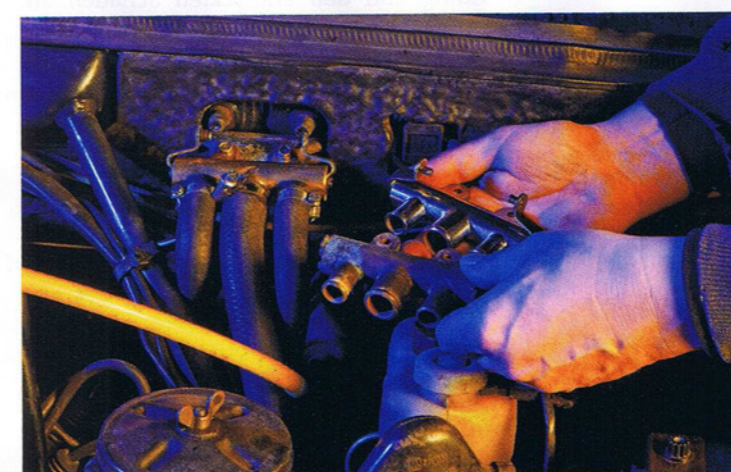
VERSCHLEISS DES HEIZUNGSREGELVENTILS Steigt der Kraftaufwand beim Betätigen der Heizungsregler, liegt das meist nicht an der Schwergängigkeit der Züge, sondern am Heizungsventil. Ralf Kühl bietet überholte Ventile auch poliert oder verchromt an
